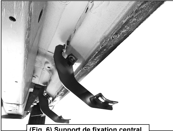
(Fig. 6) Support de fixation central côté conducteur/gauche installé
